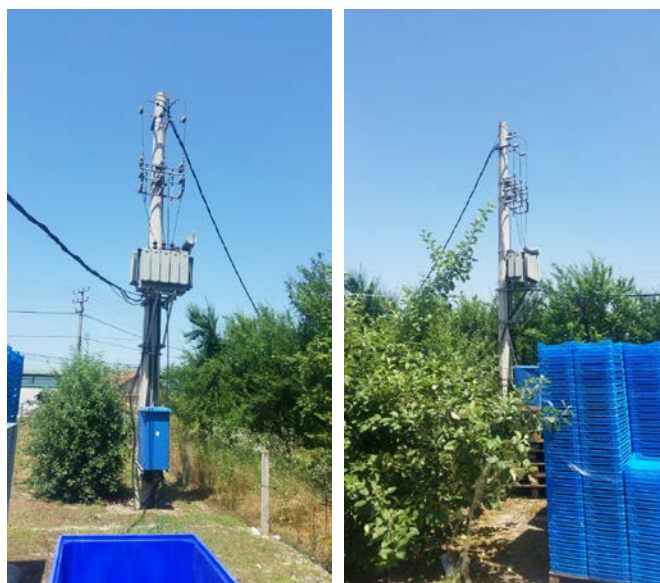
Slika br. 2. Stubna trafostanica na kp 156 KO Stupčevići
